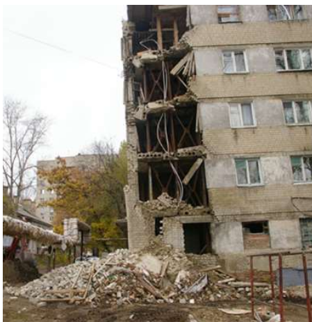
Рисунок 2. Обрушение одного из жилых домов г. Саратова
