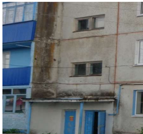
Последствия протечки кровли здания
