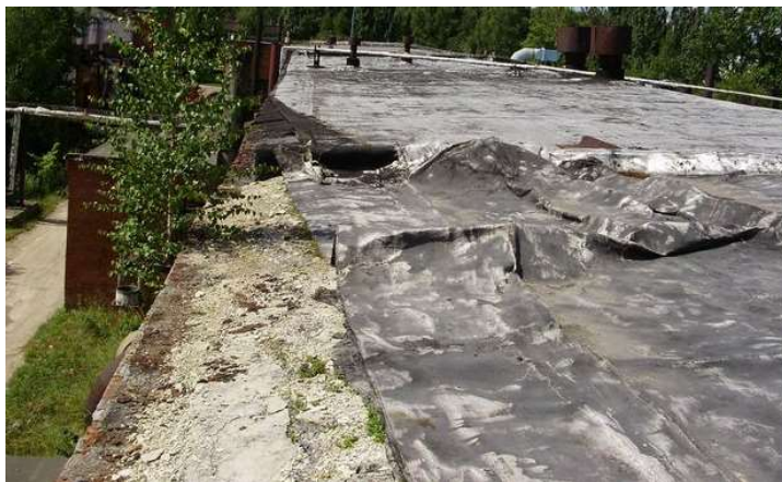
Состояние кровли многоэтажного панельного жилого дома
