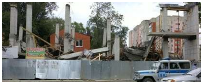
Рисунок 3. Обрушение конструкций каркасно-панельного здания
