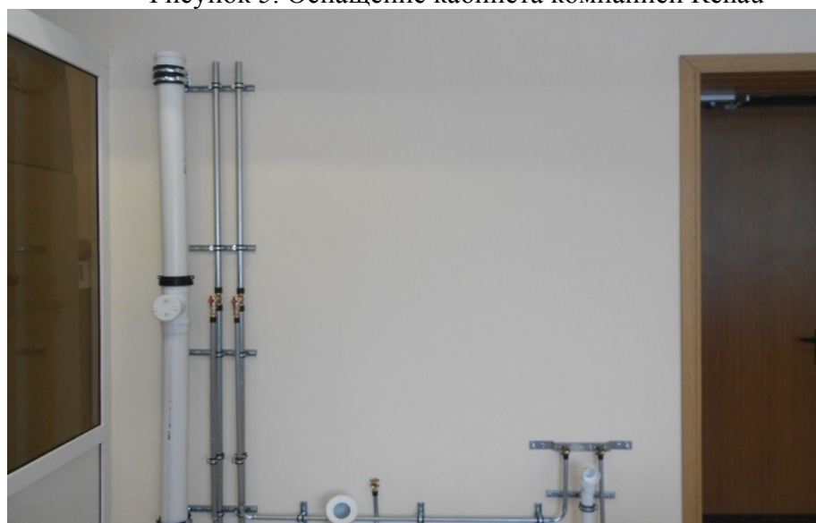
Рисунок 6. Оснащение кабинета компанией Rehau
