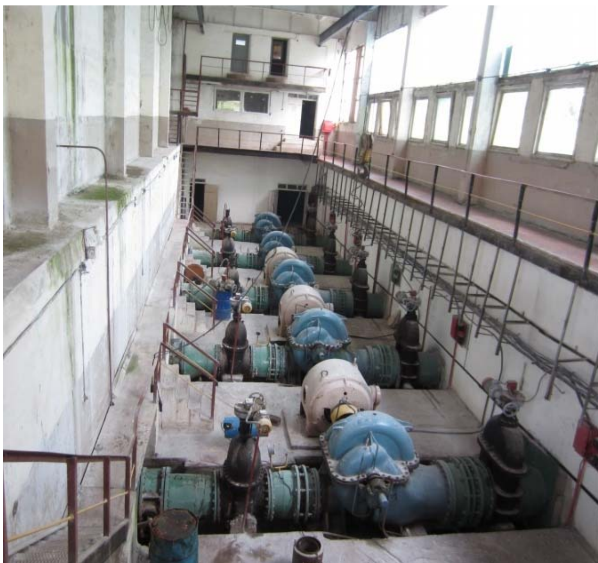
Рисунок 3. Оборудование насосной станции НСП-2
